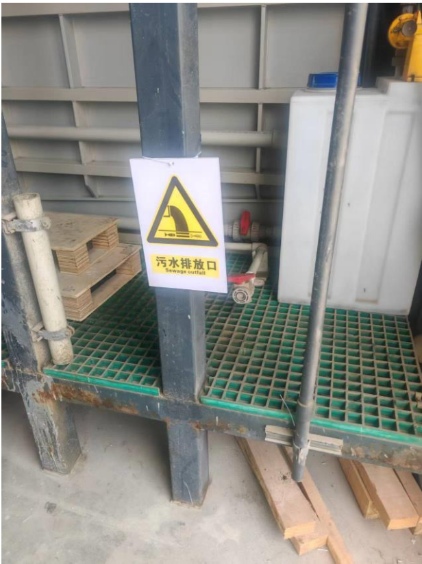
含镍废水处理出口
