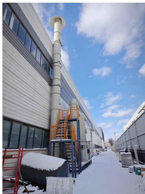
DA001 及碱喷淋设施
