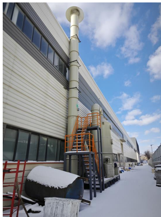
废气排放口、采样平台
